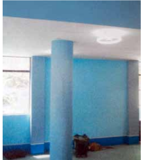
Instalaciones de Iluminación eléctrica de la Biblioteca Comunal recién terminada. Distrito Mariscal Castilla. Año 2007.
