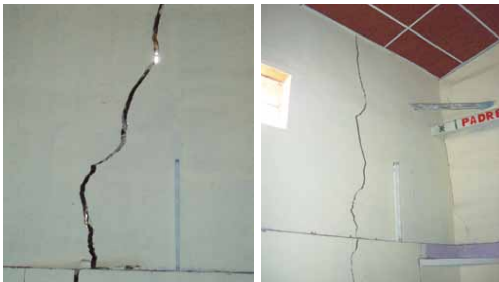
Rajaduras de las paredes laterales de la iglesia de Comas. Año 2011.
