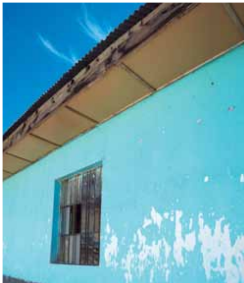
Muro de local comunal con pintura deteriorada, distrito de Yanacancha. Año 2011.
