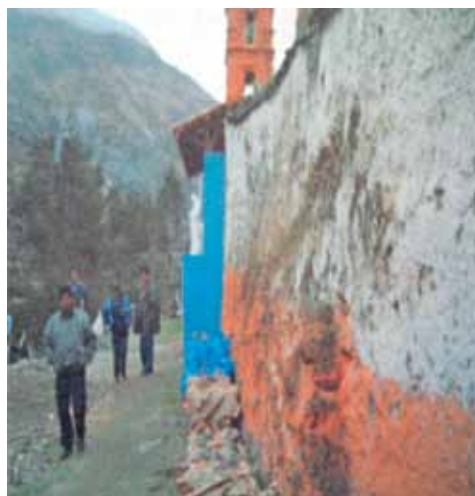
Muro del cementerio sin concluir, distrito de Ulcumayo, Año 2007.
