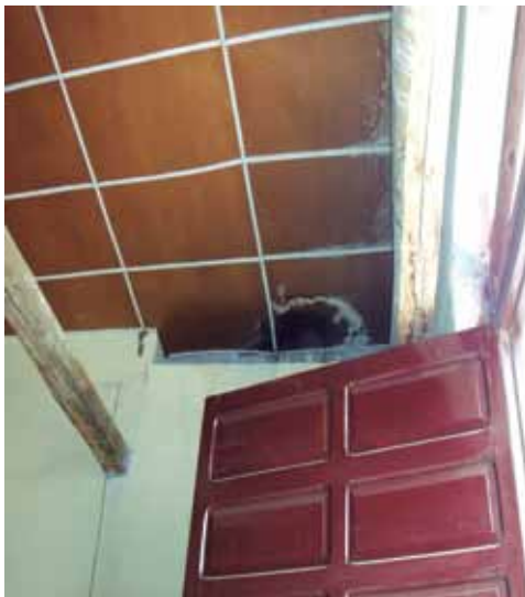
Cielo raso perforado por la humedad. Iglesia de Comas. Año 2011.
