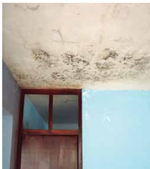
Filtraciones en el techo por humedad en Biblioteca comunal. Distrito Mariscal Castilla. Año 2011.
