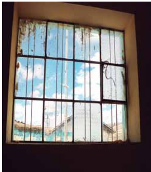
Ventana rota y sucia en local comunal, distrito de Yanacancha, Año 2011.
