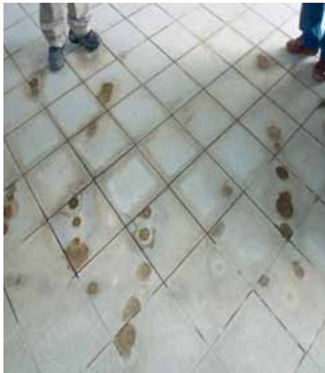
Filtraciones en el suelo y corrosión de mayólicas por humedad en Biblioteca comunal. Distrito Mariscal Castilla. Año 2011.
