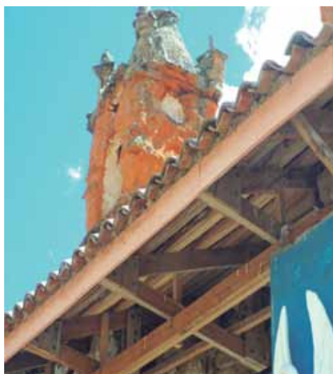
Conservación de vigas de parte frontal del cementerio, distrito de Ulcumayo. Año 2011
